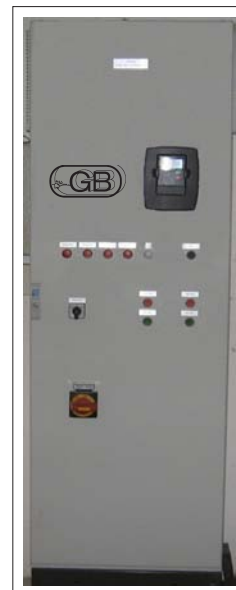
modernster Elektro-Schalt-schrank mit integriertem Frequenzumformer für daueroptimierte Trocknungsleistung.
